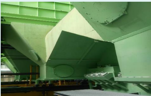
供料净化蜗壳系统升级改造
