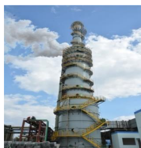
罐式炉烟气脱硫装置
