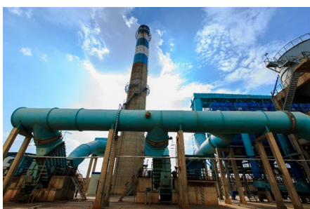
焙烧炉烟气脱硫装置
