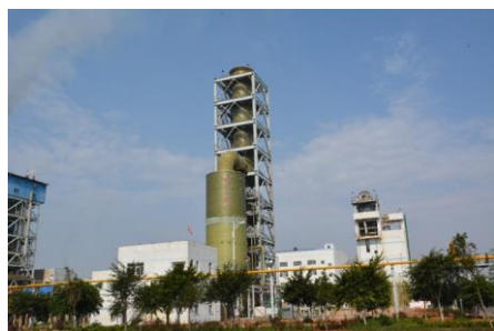
煅烧回转窑烟气脱硫装置
